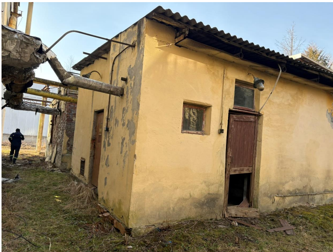
Мал. 7. Газо-розподільчий пункт, який розміщений на території ділянки
